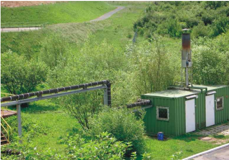
Rys. 3. Pochodnia wraz z kontenerem do spalania biogazu (źródło: własne)
